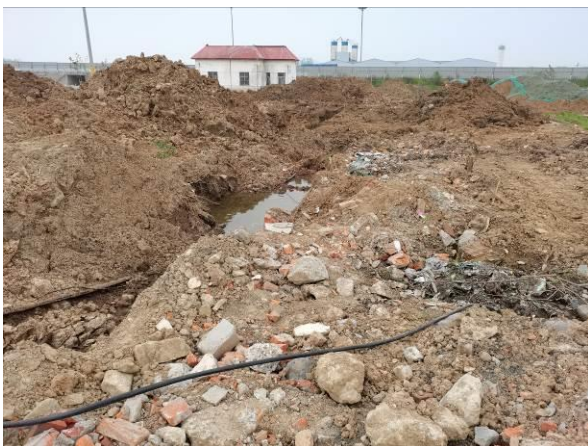
项目区域内临时排水
